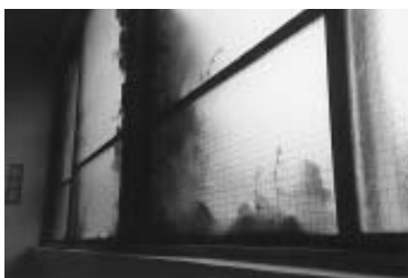
さびて開かない窓 (林町小)
