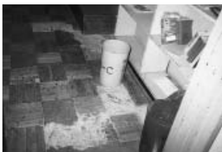
教室の床がはがれたまま (六中)
