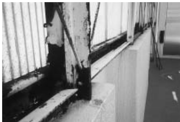
腐食しているフェンス (十中)
