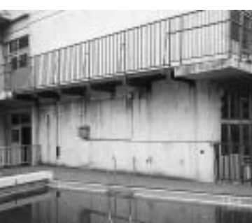
外壁に汚れが目立つ (指ヶ谷小)
